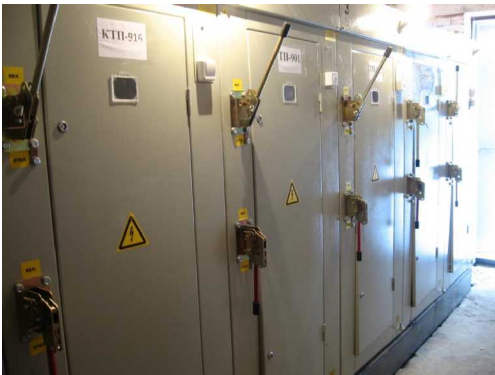
Рисунок 6 - общий вид РУ-6(10) кВ в ТП.
