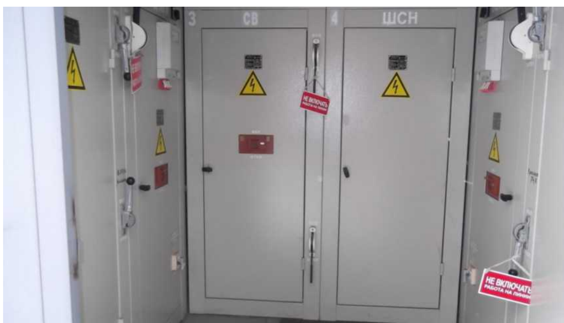
Рисунок 5 - Общий вид РУ-0,4 кВ ТП, КТП.
