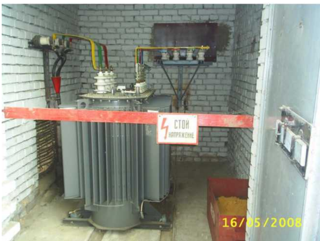
Рисунок 11 - Трансформатор марки ТМГ на ТП МУП «ВГЭС».
