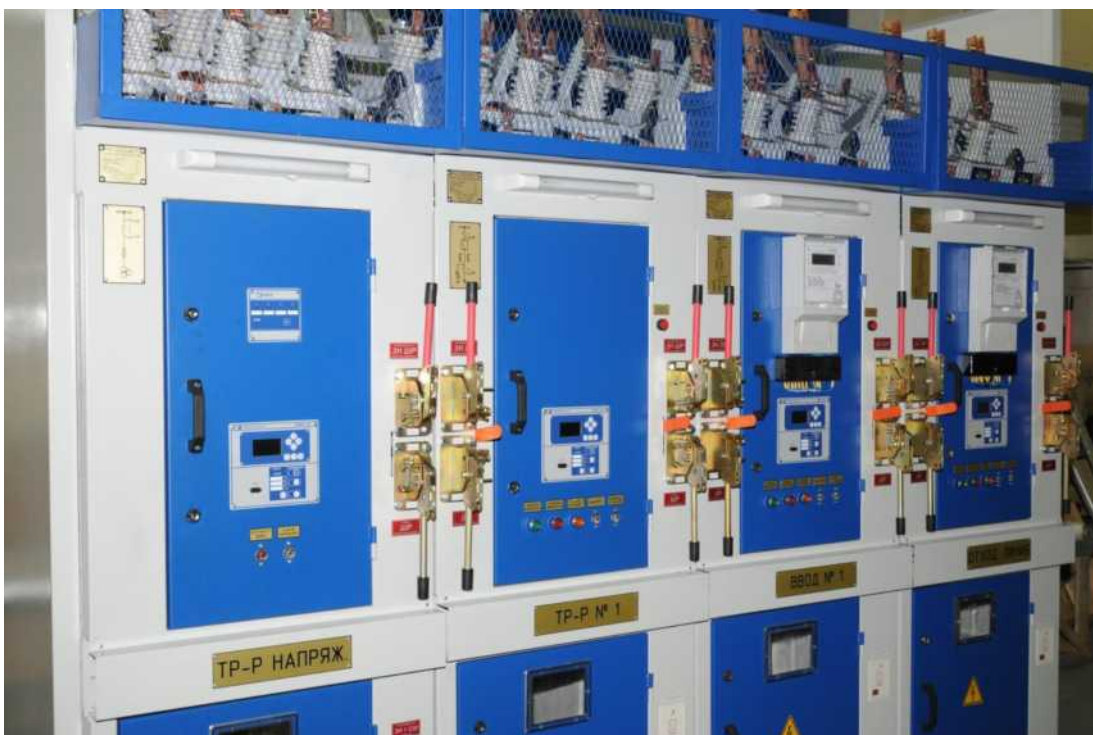
Рисунок 7 - Общий вид РУ-6(10) кВ в РП(РТП).
