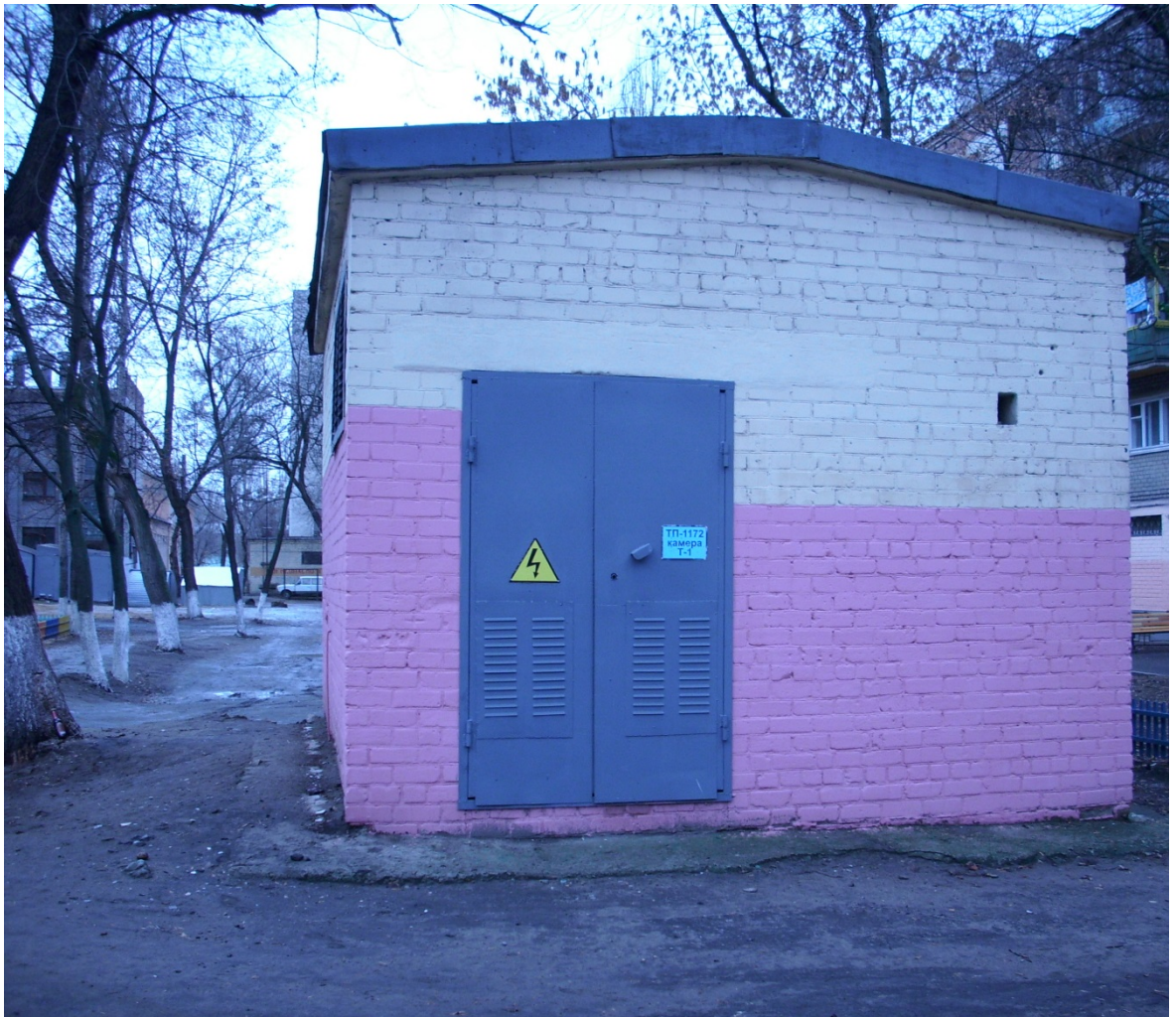
Рисунок 1 - ТП-1172 в кирпичном исполнении.
